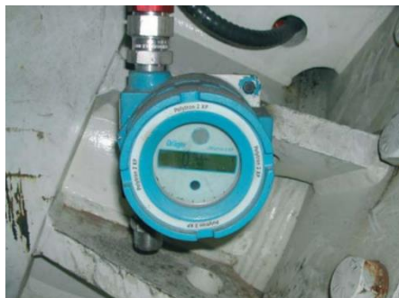
شکل ۴-۱۵: حس‌گر گاز متان نصب شده بر روی TBM (Guglielmetti et al., 2008)
