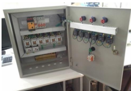
شکل ۵-۲۳- تابلوی برق دستگاه
