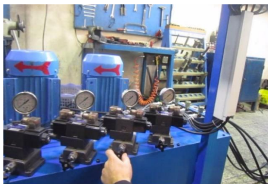
شکل ۶-۱۵- پیچ دستی نصب شده بر روی فشار سنج برای افزایش یا کاهش فشار
