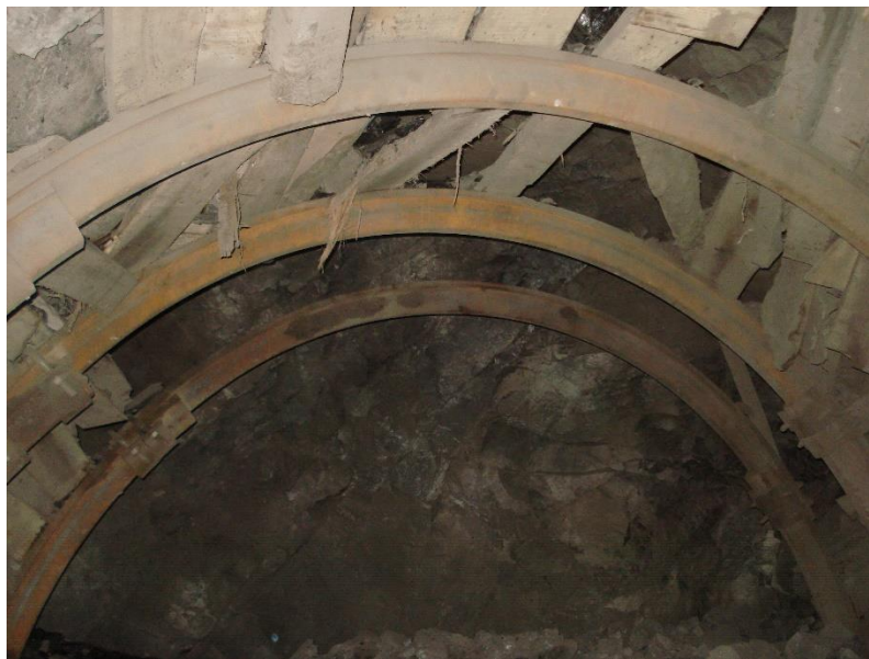
شکل ۱۰-۳: آسیب به سیستم نگهداری پس از انفجار انجام شده در مقطع ۱.
