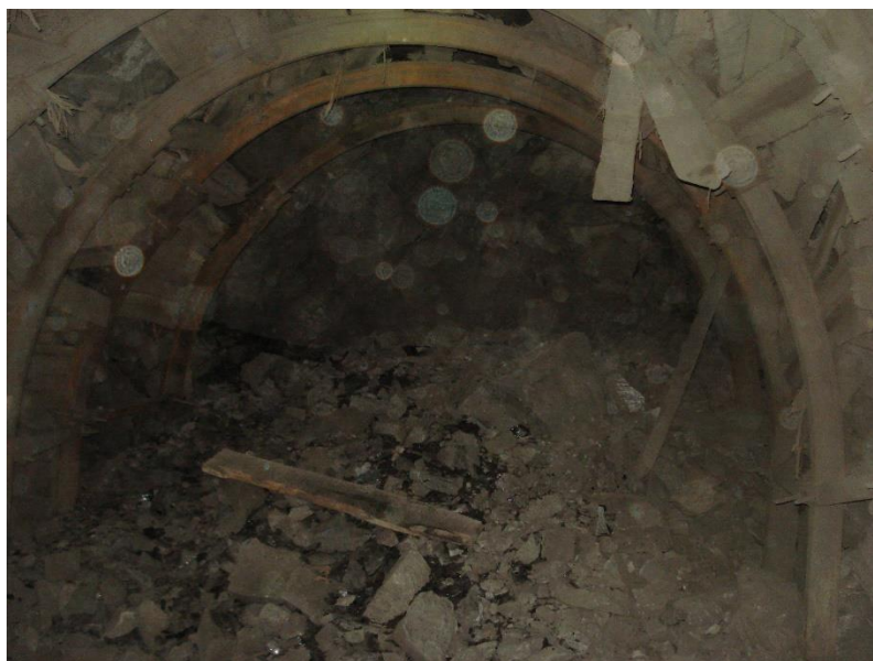
شکل ۱۱-۳: آسیب به سیستم نگهداری پس از انفجار انجام شده در مقطع ۲.
