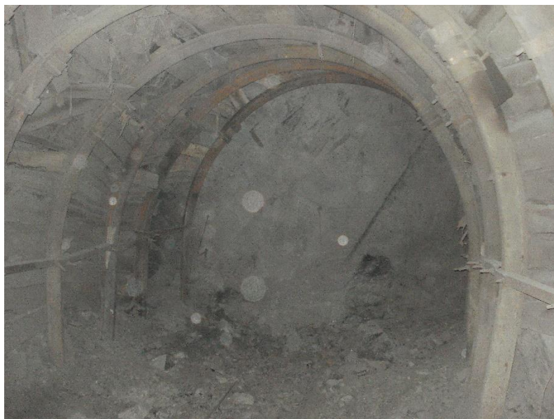
شکل ۳-۱۲: آسیب به سیستم نگهداری پس از انفجار انجام شده در مقطع ۳.
