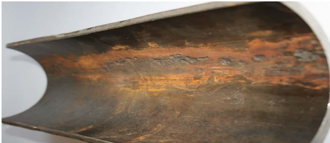
شکل ۱۵-۲: نمونه‌ای از خوردگی داخلی لوله جداری (Bellarby, 2009)
