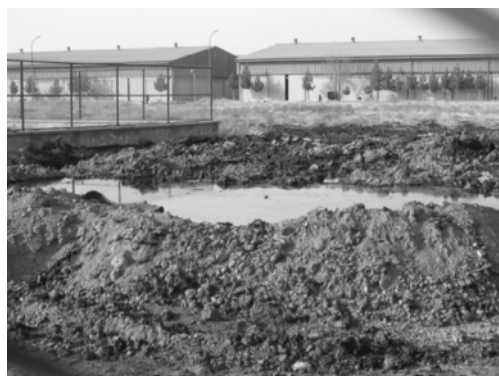
شکل (۵-۱۶): نشت نفت از خط لوله جاسازی شده (Idemitsu engineering Ltd, 2003).
