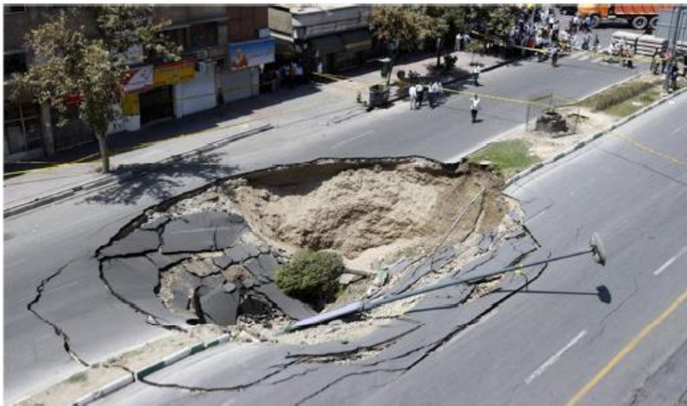
شکل (۱-۲): نشست سطح زمین ناشی از تخریب قنات‌های قدیمی بر اثر حفر تونل مترو تهران (جعفر پیشه، ۱۳۸۳).
