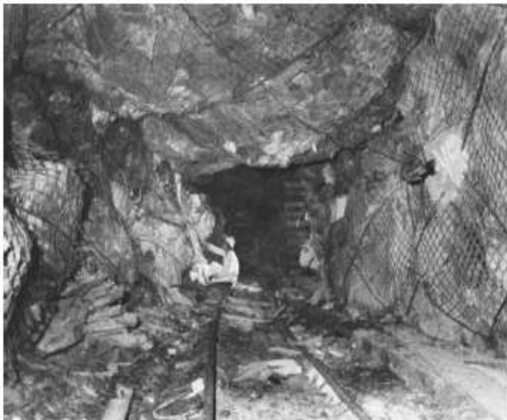
شکل ۵-۲- نمای قسمتی از تونل باربری که نزدیک گسل است پس از پدیده لرزه‌ای ۴ ریشتری [5]
