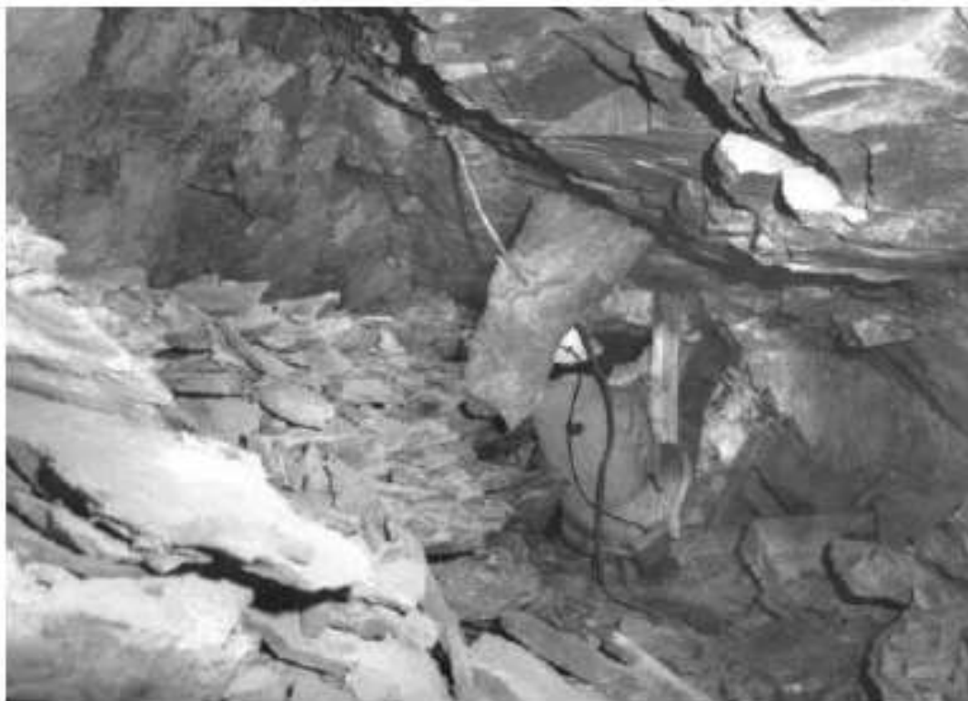
شکل ۲-۴- نمایی از بالا، آوار ریخته شده از سقف تونل که باید ۳/۵ متر ارتفاع می‌داشت. تکه‌های یک اندازه و تیز قابل توجه است [5].
