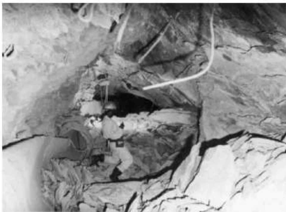
شکل ۲-۶- نمایی از آسیبی در طول چندین تونل کوارتزیتی در عمق ۲۵۰۰ متری رخ داده است به همراه لوله تهویه آسیب دیده توسط ترکیدن خودبه‌خودی سنگ [5].
