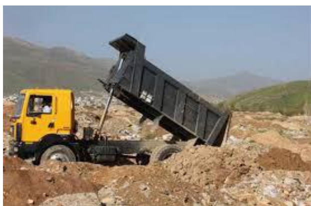
شکل ۴-۵- گرد و غبار تولید شده ناشی از تخلیه بار در محل انباشت باطله
