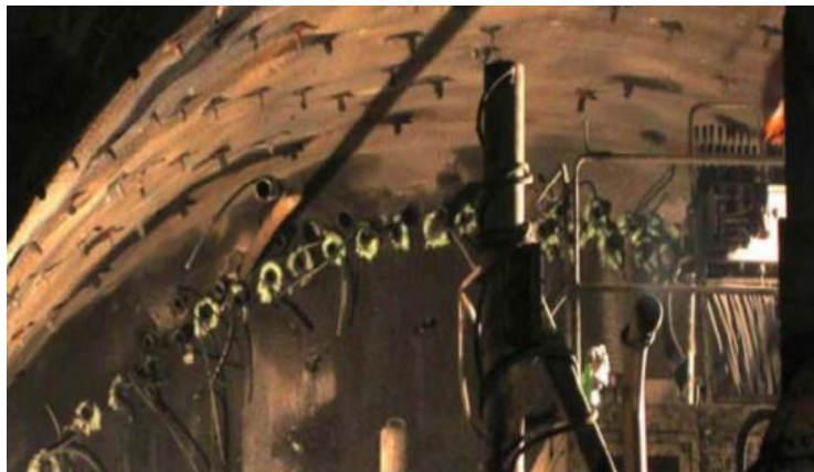
شکل ۳-۱۱: عدم نصب صحیح و گیرکردن لوله در روش پیش حفاری (Volkmann et al, 2008).
