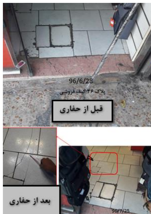
شکل ۴-۴: ترک‌های ایجاد شده در کف مغازه‌ها در اثر حفر تونل دسترسی.
