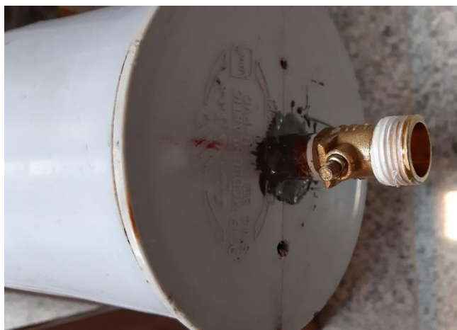
شکل ۳-۷. اتصال یکی از مخازن به لوله گرمایی ترموسیفونی
