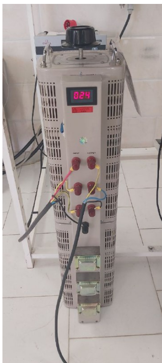
شکل ۳-۷: ترانس تنظیم ولتاژ سه فاز ساخت شرکت OMEGA کره جنوبی
