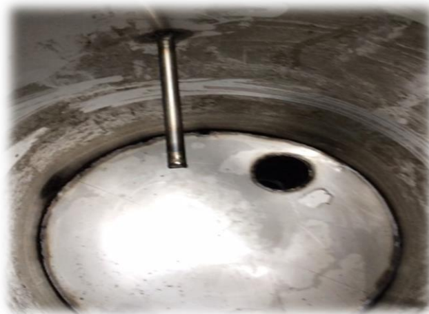
شکل ۴-۴ ترموول (THERMOWELL) نصب شده جهت نصب سنسور برای به دست آوردن دمای
