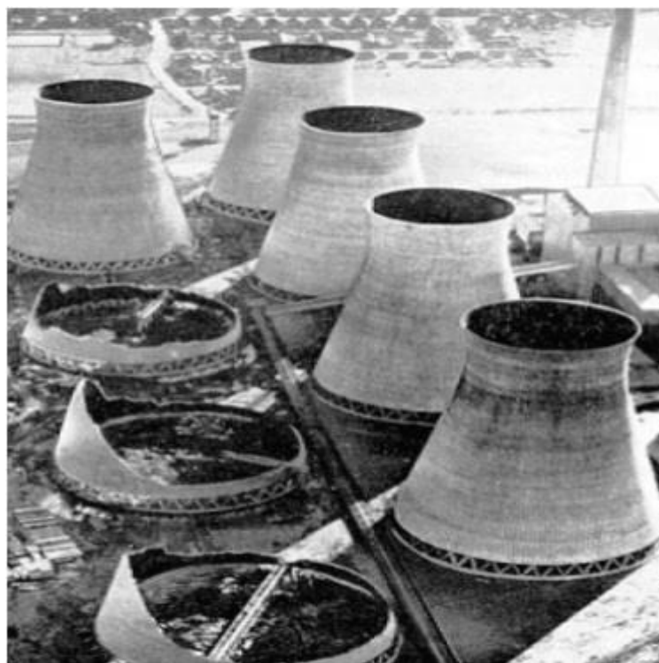
شکل ۱-۴: تخریب برج خنک کن های فری بریج توسط ارتعاشات ناشی از گردابه‌ها [۱]
