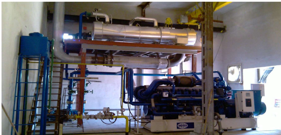
شکل (۱-۷): نمایی از کل تجهیزات CHP شامل موتور -ژنراتور، مبدل حرارتی، پمپها، ورودی گاز و غیره
