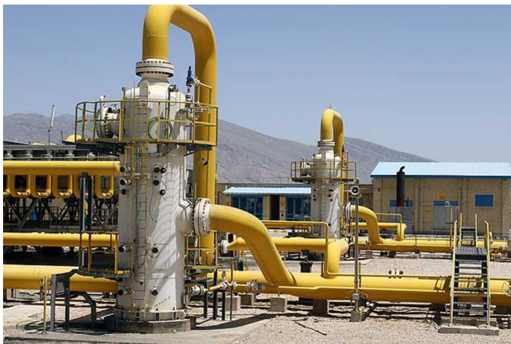
شکل ۲-۳ - بخشی از ایستگاه تقلیل فشار گاز برون شهری [۸]
