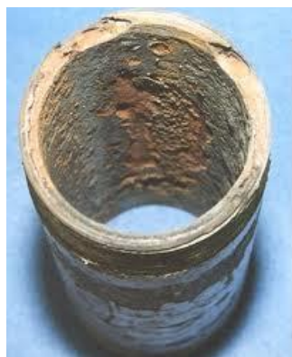
شکل ۲-۱۰ - خوردگی در قسمتی از خط لوله [۱۰]
