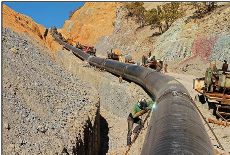
شکل ۲-۲- خطوط لوله اصلی انتقال گاز [۹]
