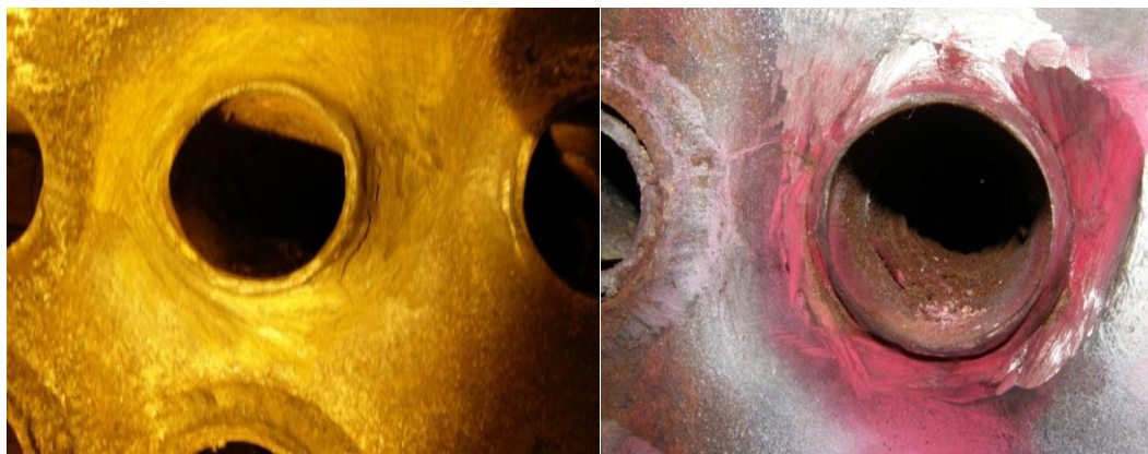
شکل (۴-۵۴): ترک و نشتی‌های پدید آمده بین تیوب و تیوب شیت [۹]
