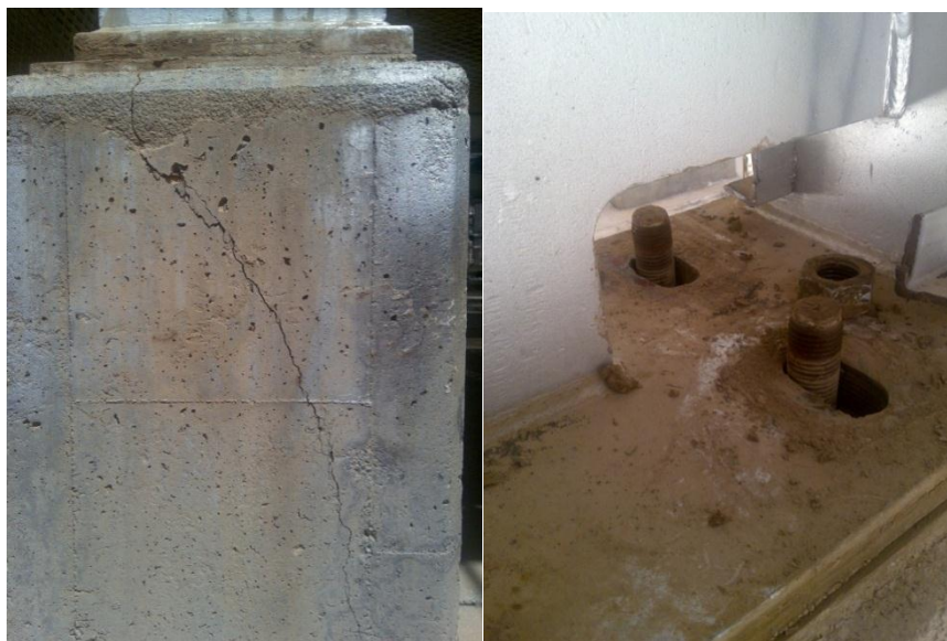
شکل (۴-۲): رسیدن لوبیایی پایه های سدل به انتهای کورس و ترک روی فوندانسیون [۹]
