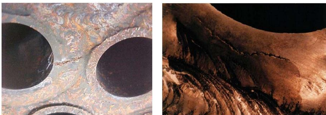
شکل (۲-۹): شکاف‌های پدید آمده بر روی جوش و تیوب [۱۱]
