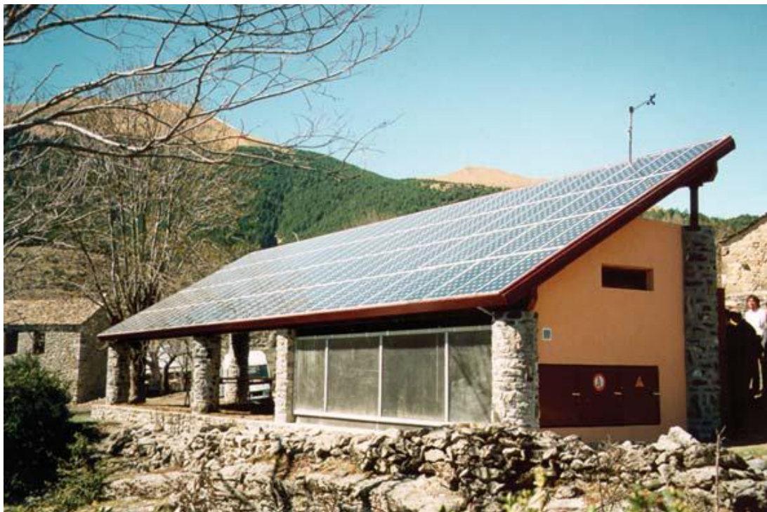
شکل ۹-۱ نمایی از سیستم فتوولتائیک خانه ای در اسپانیا
