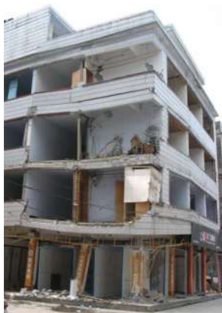
شکل ۱-۵ الف. نمونه هایی از خرابی های موضعی ایجاد شده توسط زلزله [5]
