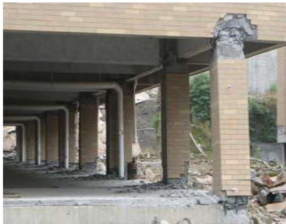
شکل ۱-۵ ب. نمونه هایی از خرابی های موضعی ایجاد شده توسط زلزله [5]
