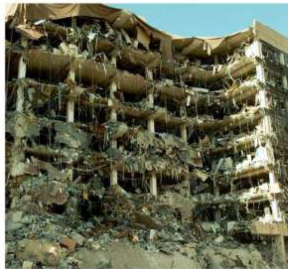
شکل ۱-۲. خرابی پیشرونده در ساختمان آلفرد مورا [1]
