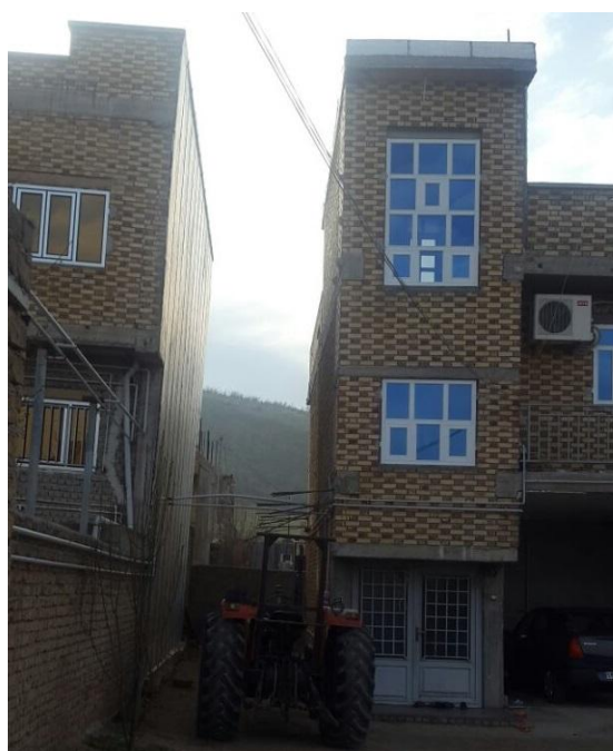
شکل (۲-۱) نشست ساختمان سمت چپ و انحنای لوله گاز به علت ساخت بر روی خاک رمبنده.
