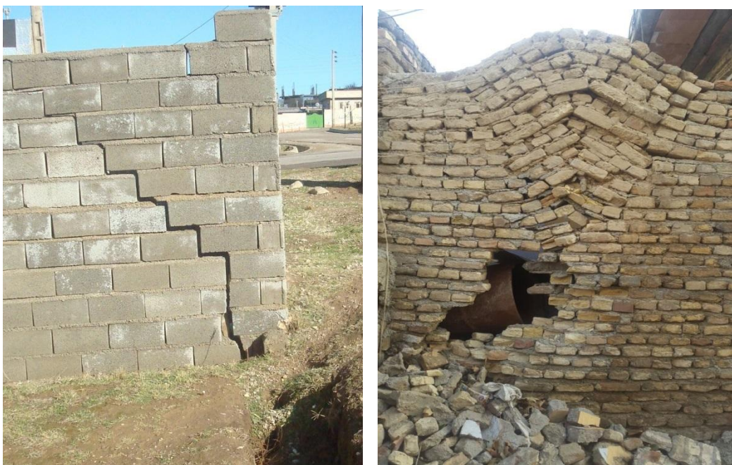
شکل (۱-۱) خرابی دیوارهای ساخته شده بر روی خاک رمبنده
