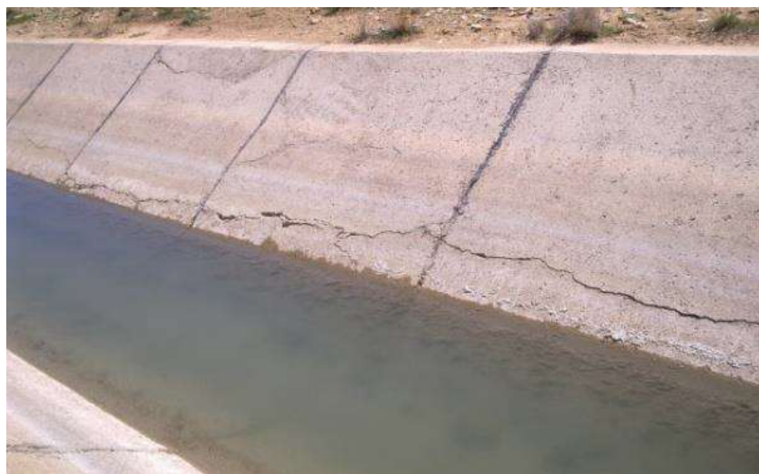
شکل ۲-۲ نمونه ای از شکستگی‌های ناشی از تورم خاک در کانال‌های زهکشی گمیشان
