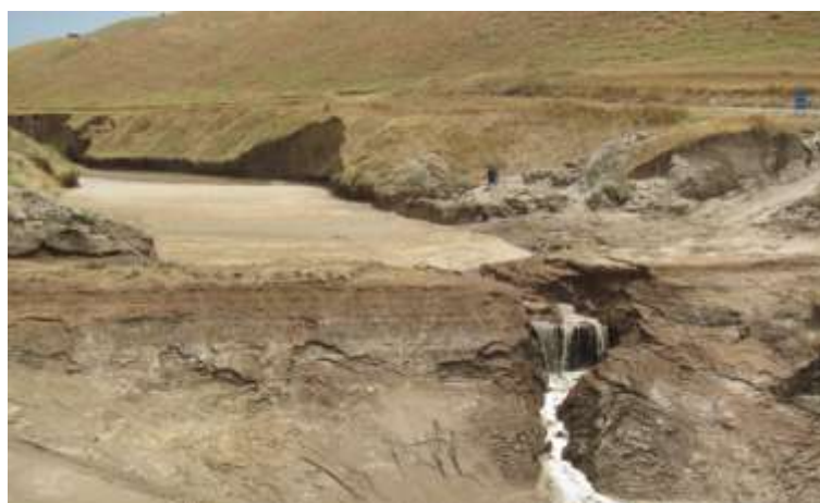
شکل ۲-۱۰ نمایی از ایجاد فرسایش به دلیل مسیر پر پیچ و خم رودخانه روستای قویجق کلاله
