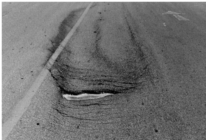
شکل ۵-۲. ترک خوردگی لغزشی
