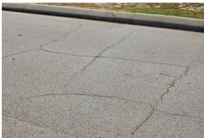
شکل ۲-۴. ترک خوردگی بلوکی
