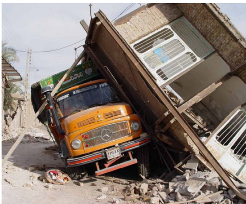
شکل ۱-۱۸ شکست برشی به دلیل عدم در نظر گرفتن اثر دیوار پرکننده (زلزله بم، ۱۳۸۲)
