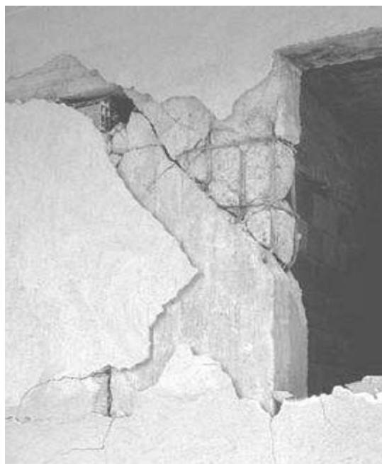
شکل ۹-۴ ستون گسیخته شده در زلزله kokaali در سال ۱۹۹۹
