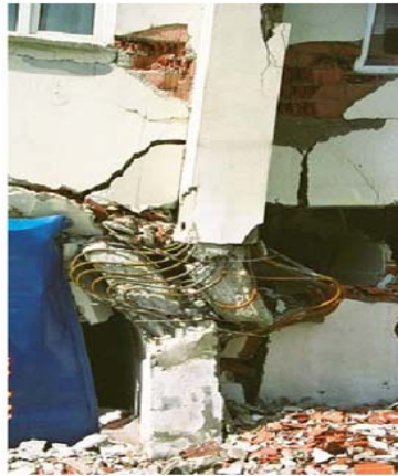
شکل ۲-۴ گسیختگی برشی و محوری ستون، زلزله Kokaeli (۱۹۹۹)
