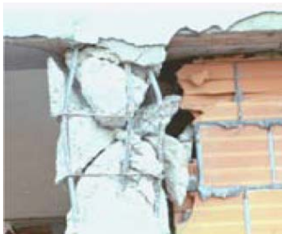
شکل ۱-۹ شکست برشی ستون به علت تقابل با دیوار پرکننده آجری با بلوک سفالی
