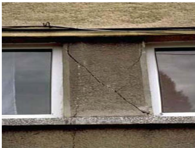
شکل ۲۰-۱ شکست ستون کوتاه
