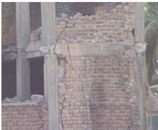
شکل ۱-۱۰ شکست برشی تیر بتن مسلح به علت اندرکنش با دیوار پرکننده آجری
