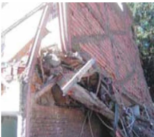
شکل ۱۴-۰ شکست طبقه‌ی نرم
