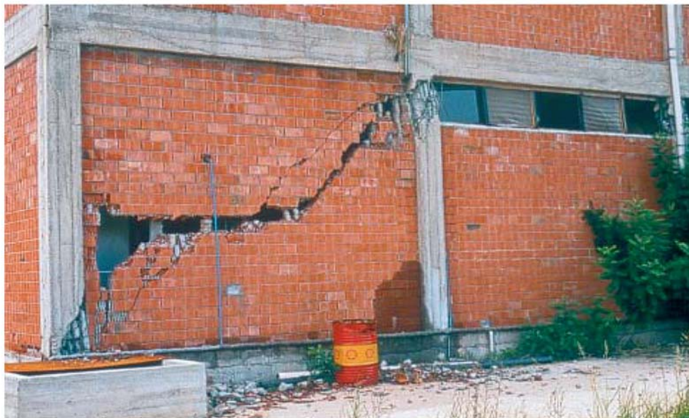
شکل ۱-۲۳ ایجاد شکست ترد برشی در ستون به علت پدیده ستون کوتاه و اندرکنش دیوار با قاب
