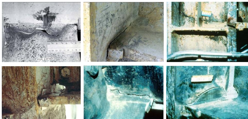
شکل ۱-۱۹. خرابی‌ها در ناحیه جوش اتصال تیر به ستون
