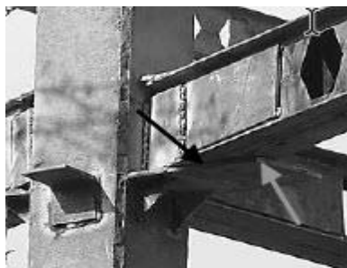
شکل ۱-۲. اجرای نادرست یک اتصال فولادی
