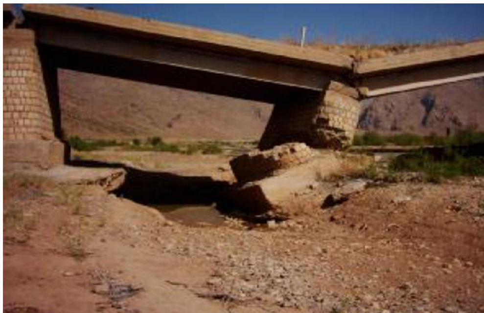
شکل ۴-۱ آبشستگی پایه پل که منجر به تخریب پل شده است (چمچال، کرمانشاه)
