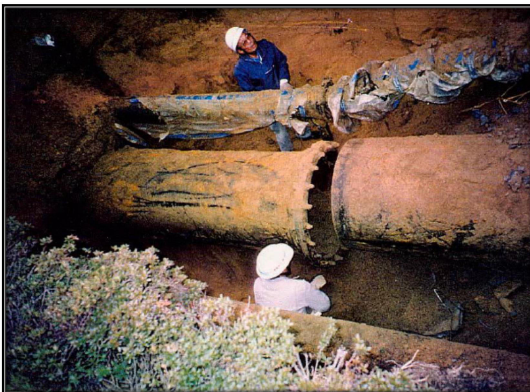
شکل (۲-۱): لوله آسیب‌دیده طی زلزله ۱۹۹۵ کوبه ژاپن (۵۹)
