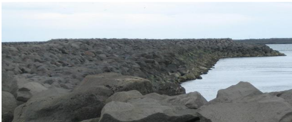
شکل (۳-۲) : نمایی از موج شکن سکویی چندلایه (موج شکن سکویی ایسلندی)
