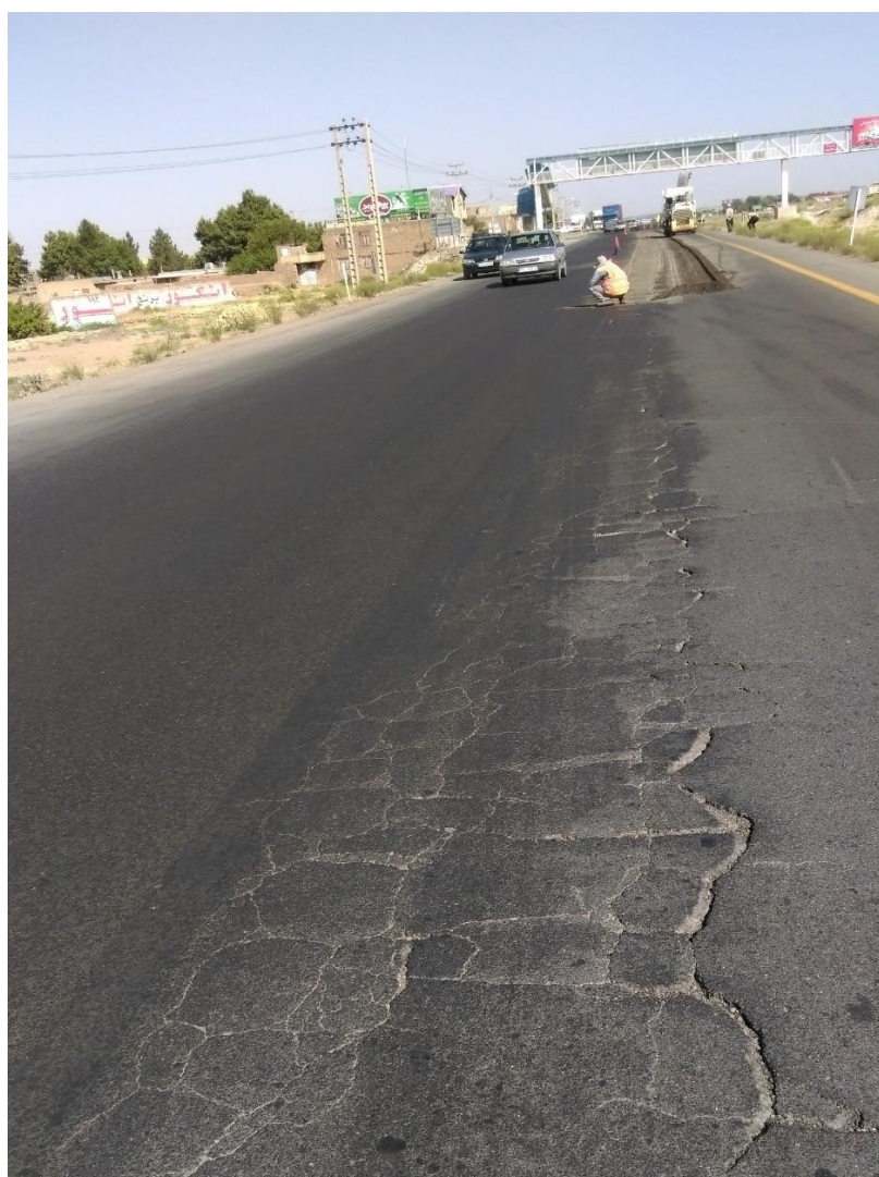
شکل (۴-۵۰) وجود ترک‌های خستگی همراه با شیارشدگی در مسیر چرخ
