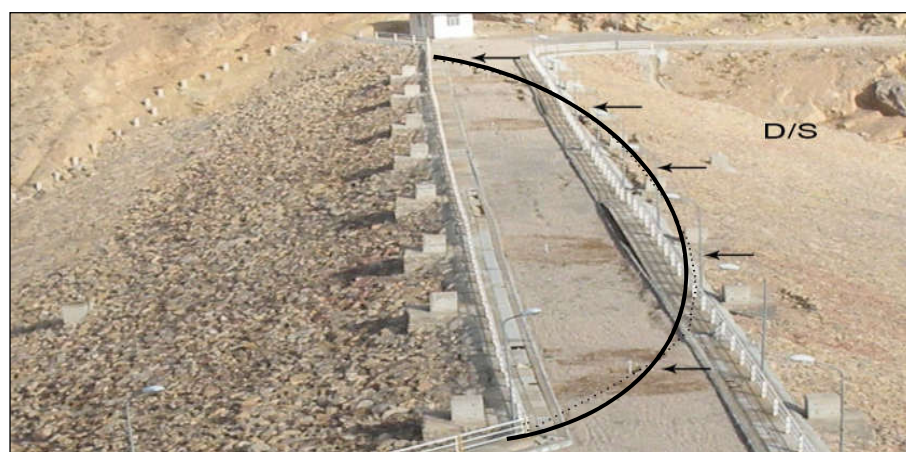
شکل (۳-۲۰) اثر قوسی شکل ناشی از ترک خوردگی
