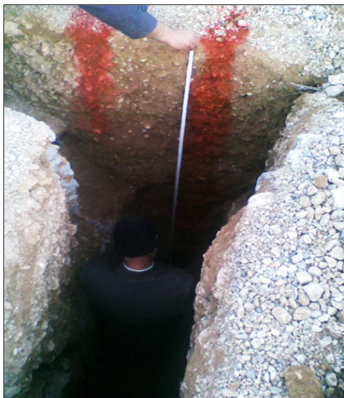
شکل (۳-۳۶) اندازه گیری عمق نفوذ مایع رنگی و ارتفاع ترک در داخل ترانشه شناسایی
