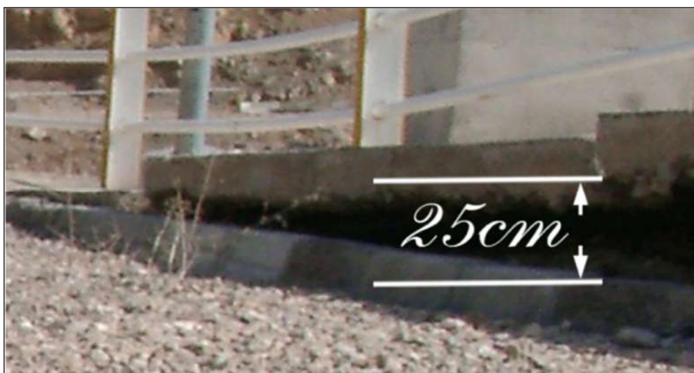
شکل (۲۶-۳) محدوده بالآمدگی تخته‌های بتنی روی تاج از اثر تنش‌های فشاری
