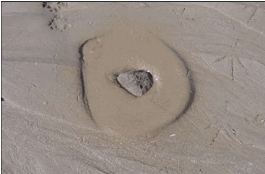
شکل (۱۸-۲) روان گرایی (Liquefaction) یا تخلیه ماسه ریزدانه از پی سد به طور موضعی
