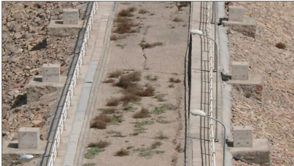
شکل (۳-۳۰) عریض شدن تاج سد در اثر تغییر شکل‌های افقی نزدیک به تکیه گاه چپ
