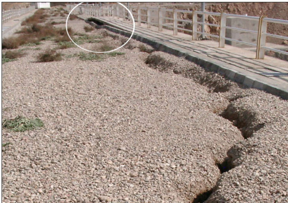
شکل (۳-۲۴) بخشی از محدوده ترک خوردگی روی تاج به شکل قوس خارجی
