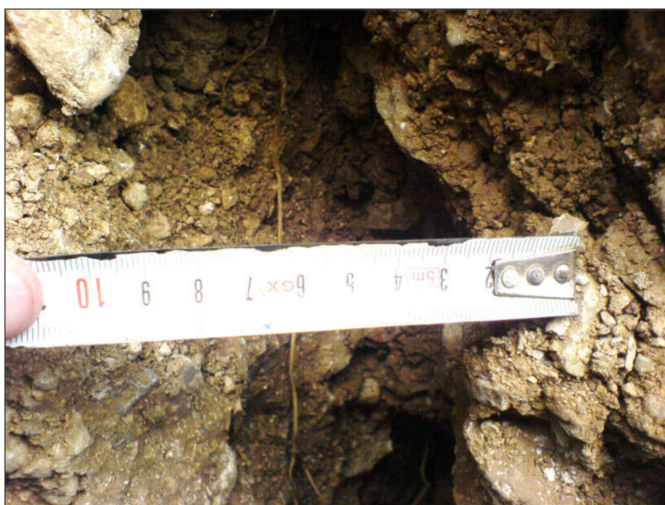
شکل (۳۹-۳) اندازه گیری عرض بازشدگی ترک‌ها در داخل ترانشه شناسایی
