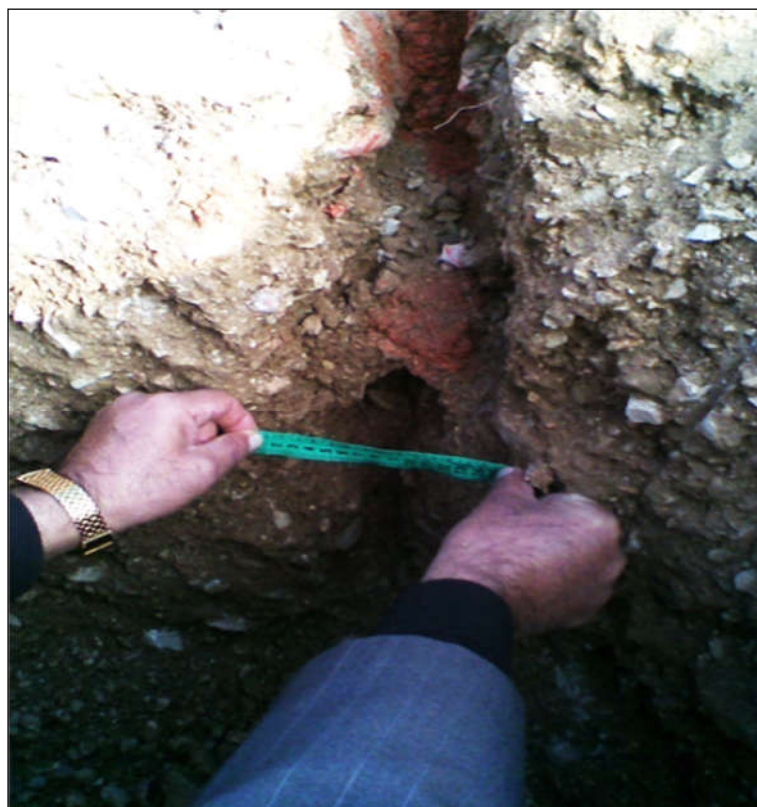
شکل (۳۸-۳) اندازه گیری عرض بازشدگی ترک‌ها در داخل ترانشه شناسایی
