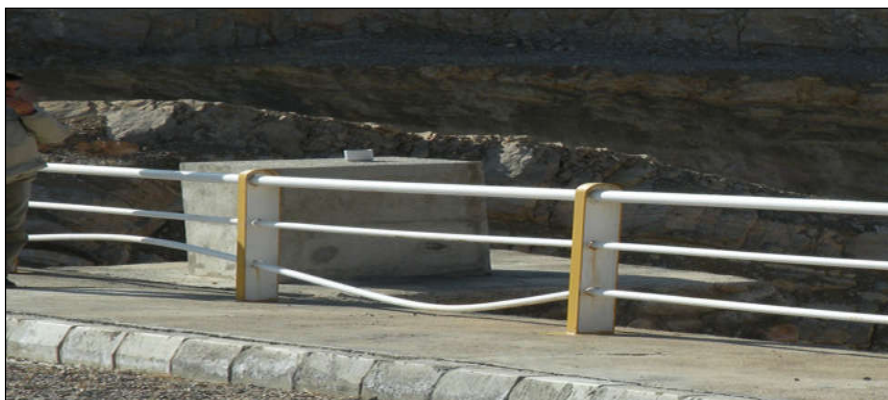
شکل (۳-۲۸) قوس خوردگی نرده‌های روی تاج سد از اثر تنش‌های فشاری
