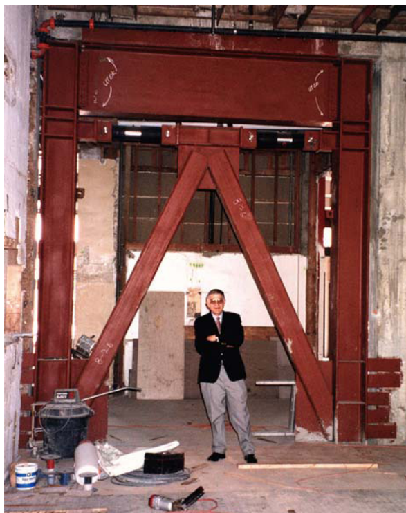
شکل (28-2): نصب میراگر در هتل Woodland
