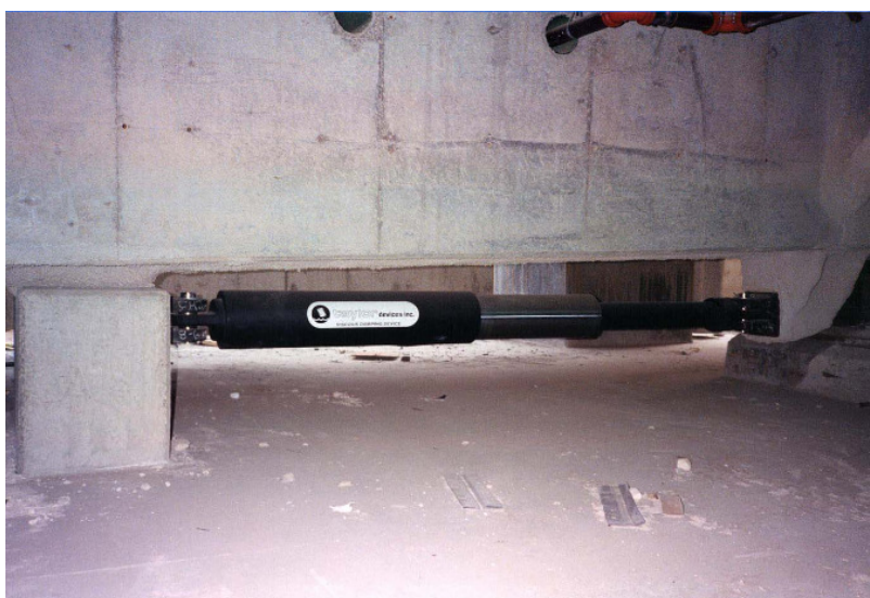
شکل (27-2): نصب میراگر در سیستم جداساز مرکز پزشکی Arrowhead Regional
