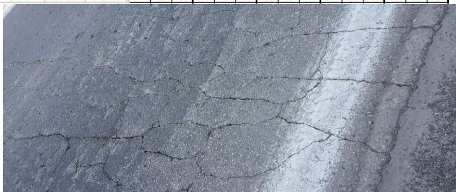
شکل ۴-۵- جدول گزارش خرابی به همراه تصویر ترک بلوکی معادل آن
