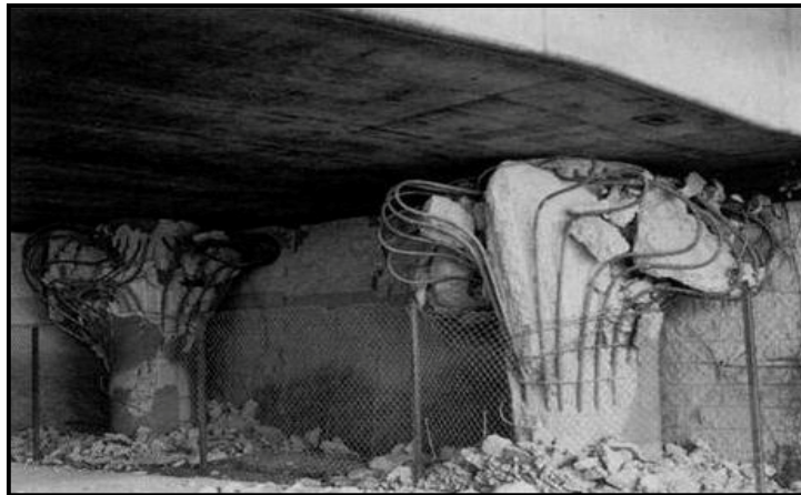
شکل (۳-۶): خرابی پایه‌ی یک پل در لس آنجلس به دلیل کمبود آرماتورهای عرضی
