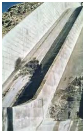
شکل ۲-۴ خسارت کاویتاسیون سرریز سد کارون ۱
