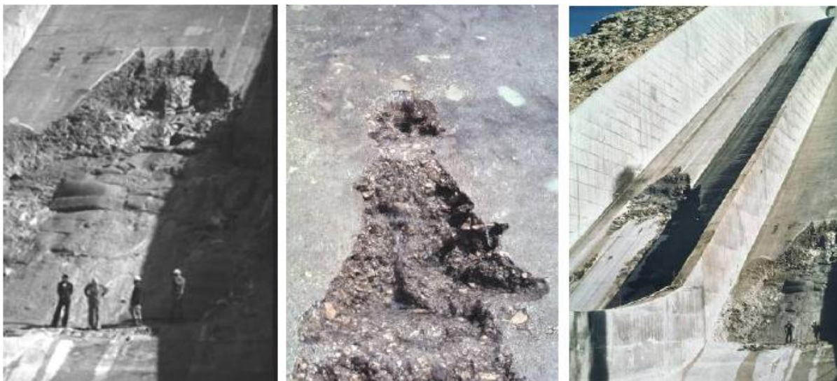
شکل (۲-۳): خسارت کاویتاسیون در سرریز سد کارون یک (شهید عباسپور)
