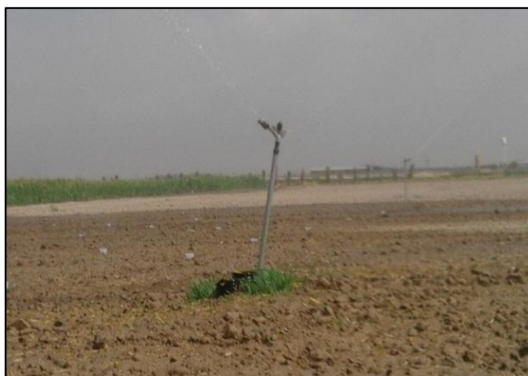
شکل ۴-۵۱- عدم شاقول و عمود بودن رایزر در سیستم‌ها
