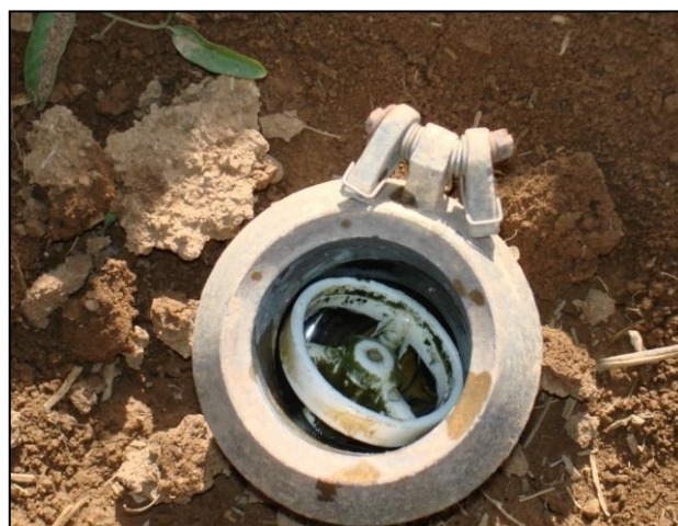
شکل ۴-۴۷- نمونه‌ای از شکسته شدن ستاره شیرخودکارهای سیستم‌ها در اثر استفاده نادرست
