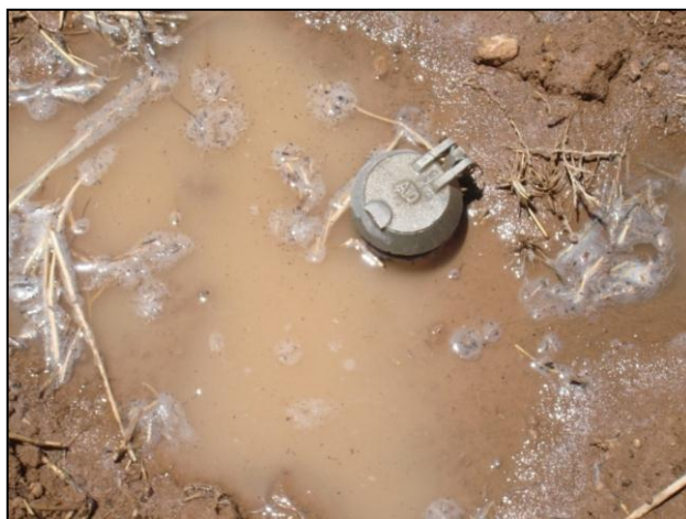
شکل ۴-۴۵- عدم آب‌بندی صحیح شیرخودکارهای سیستم‌ها و نشت آب از آنها
