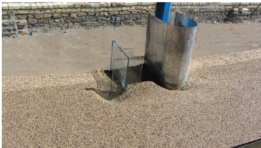
شکل (۱۱-۳) - چاله آبشستگی در اطراف تکیه‌گاه و آبشکن
