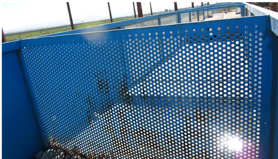
شکل (۳-۳) - صفحه مشبک نصب شده در ابتدای کانال
