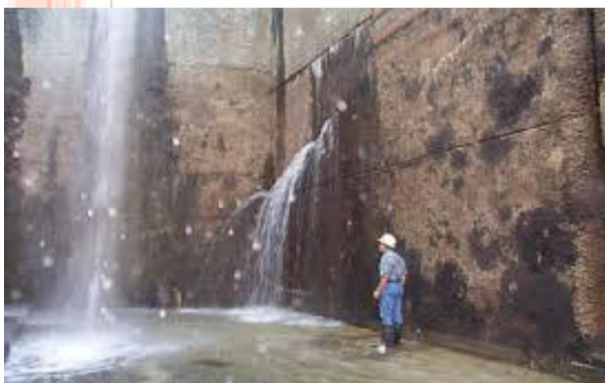
شکل ۲-۶- نشت آب در بدنه سد
