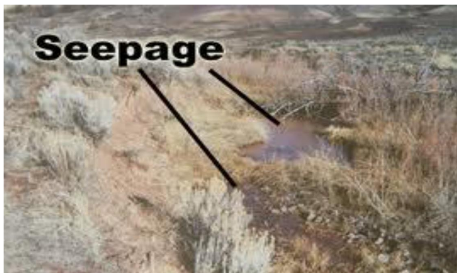
شکل ۴-۲- نشت آب در پایاب سد
