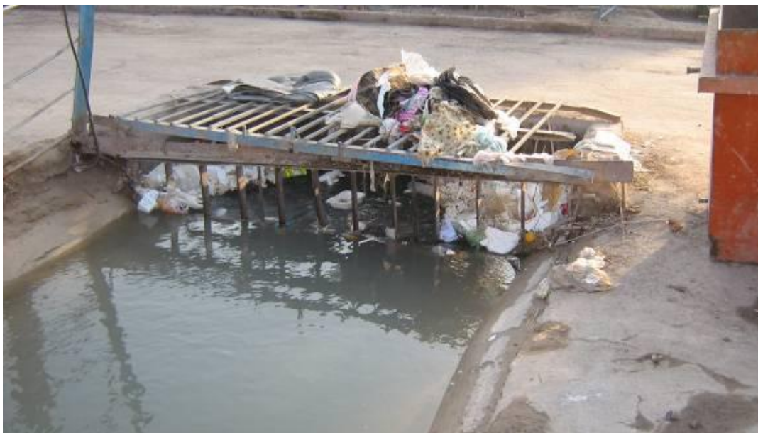
شکل ۴-۱۴- تجمع زباله در ورودی سیفون تقاطعی کانال X۳ با بلوار راه آهن گرمسار
