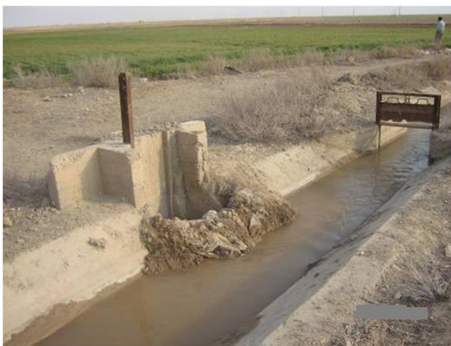
شکل ۴-۲۸- کانال‌های فرعی بلااستفاده و دریچه‌های آبگیر مربوطه
