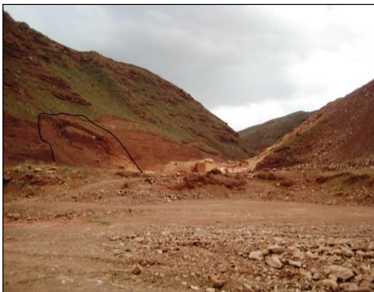
شکل (۴-۱۳)- زمین لغزش سطحی در اثر ترانشه زنی و فعالیت انسانی (نگاه به سمت جنوب شرق)
