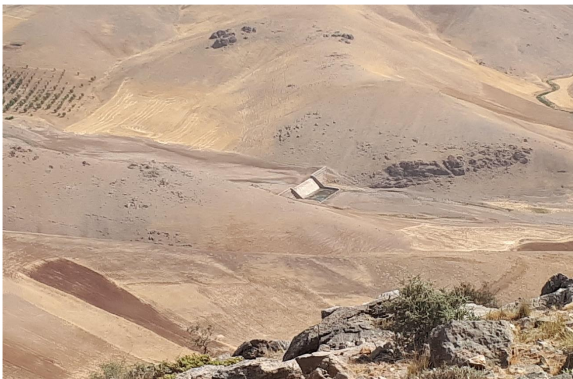
شکل ۵-۴۳- عملیات عمرانی در پایین دست چشمه (سد کبوترلانه) و یکی از بندهای احداثی در حوضه آبخیز چشمه (بالادست)
