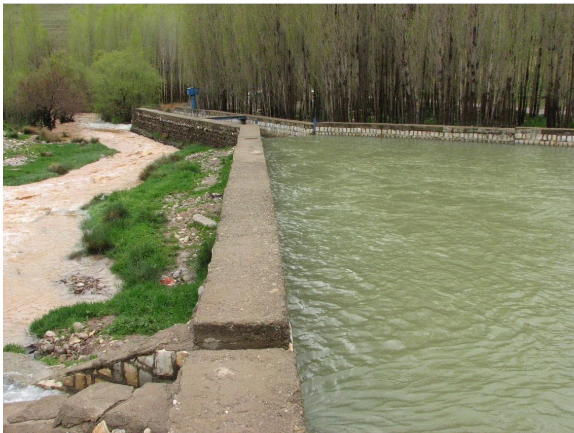
شکل ۴۴-۵- کانال اصلی اندازه‌گیری دبی چشمه کبوترلانه و مسیل سیلاب. وجود احتمال تداخل بیش از احداث کانال
