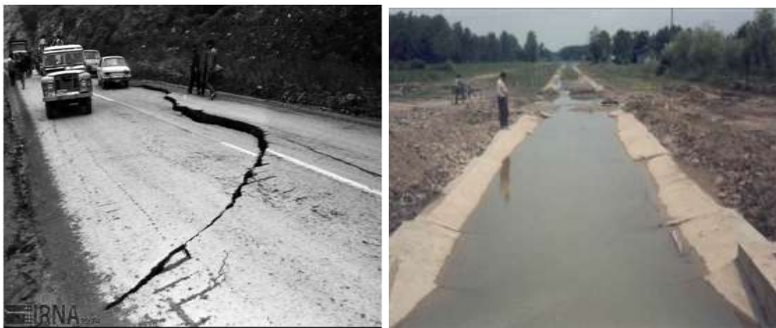
شکل ۲-۳ خرابی جاده‌ها و راه‌آبها به واسطه‌ی روانگرایی در زلزله‌ی رودبار-منجیل [۵۰]
